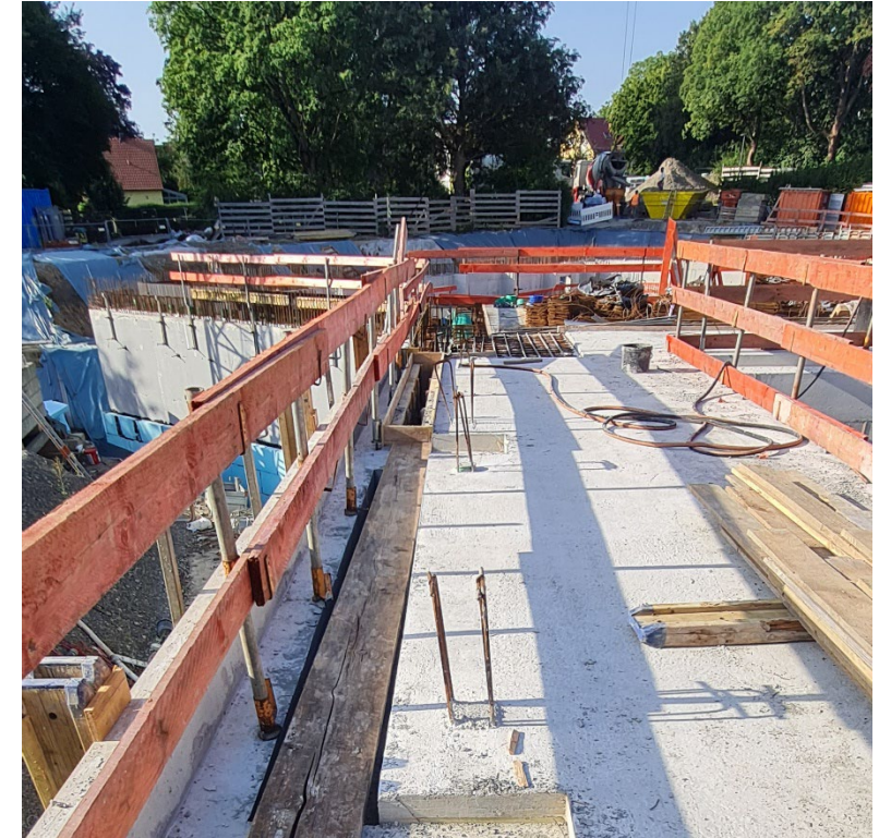
August 2025, Lüftungsrinne Lehrschwimmbecken
