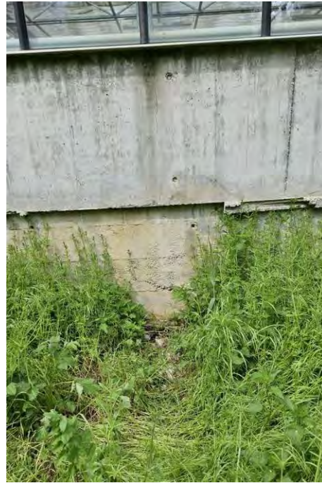
Abb. 7: Untersuchung lückig bewachsener Stellen mit Kies und Hohlräumen am Gärtnereigebäude.
