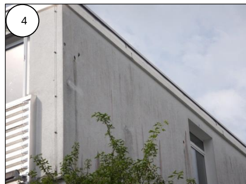
Gebäudefassade kleinen Spalten
